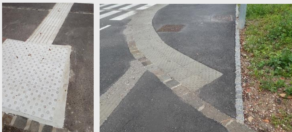
Sliki 8 (neustrezno): Primera nenatančne izvedbe taktilnih oznak. 1. Izvedba z načinom naknadne vgradnje. Izrez za taktilne oznake je bil prevelik glede na predvidena polja. Vsaka dodatna zapolnitev z raznimi materiali pomeni več neravnin v tleh, kar je neustrezno tako za tipno zaznavnost kot tudi za prevoznost s pripomočki na kolesih. 2 (neustrezno) Izvedba z načinom predhodne vgradnje, pri kateri je bila struktura ob asfaltiranju zelo poškodovana, taktilne oznake pa niso bile izvedene do roba. Če hodi uporabnik bele palice ob robu zelenice, je zelo verjetno, da čepastih oznak ne bo zaznal – opozorilni čepasti pas tako ne bo opravil svoje funkcije.
