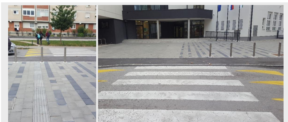
Sliki 15 (neustrezno): Primer neusklajenega načrtovanja ceste in zunanje ureditve pri šoli. 1. Taktilna vodilna linija, ki vodi do vhoda v šolo, se na drugem koncu zaključi na robu pločnika brez čepaste oznake, ki bi označevala zaključek taktilnega vodenja. Če pešec nadaljuje naprej v isti smeri, pride do prehoda za pešce (ki ni taktilno označen) in sicer izven območja zebre. Neposredno ob taktilni liniji stoji količek, v katerega se uporabnik bele palice zaleti, če hodi ob taktilni oznaki po desni strani. 2. Kontrastni vzorci v tlaku poudarjajo vhod v šolo, ki je na desni strani, vendar je takšen poudarek zavajajoč, saj ni ustrezno povezan s prehodom za pešce. Vzorci v tlaku bi v tem primeru morali usmerjati od prehoda za pešce proti vhodu, saj je ključno poudariti varno pot do šole.
