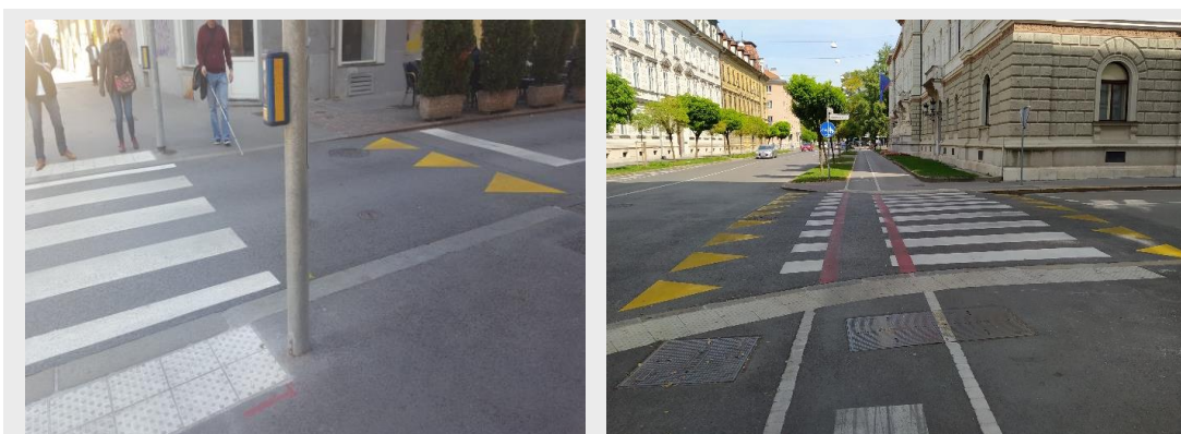
Sliki 10: Oznaki roba peščeve površine na prehodu za pešce. 1 (neustrezno): Primer nezaščitenega roba vozišča. Rob trapezne grbine je pomaknjen daleč izven prehoda za pešce, zato bi bilo treba taktilne oznake podaljšati izven prehoda za pešce do konca grbine. 2 (ustrezno): Oznaka na dvignjeni trapezni ploščadi mora segati tudi izven zebre, vse do mesta, kjer je višinska razlika med voziščem in površino za pešce že dovolj visoka, da jo lahko zaznamo s tipom (vsaj 3 cm).
